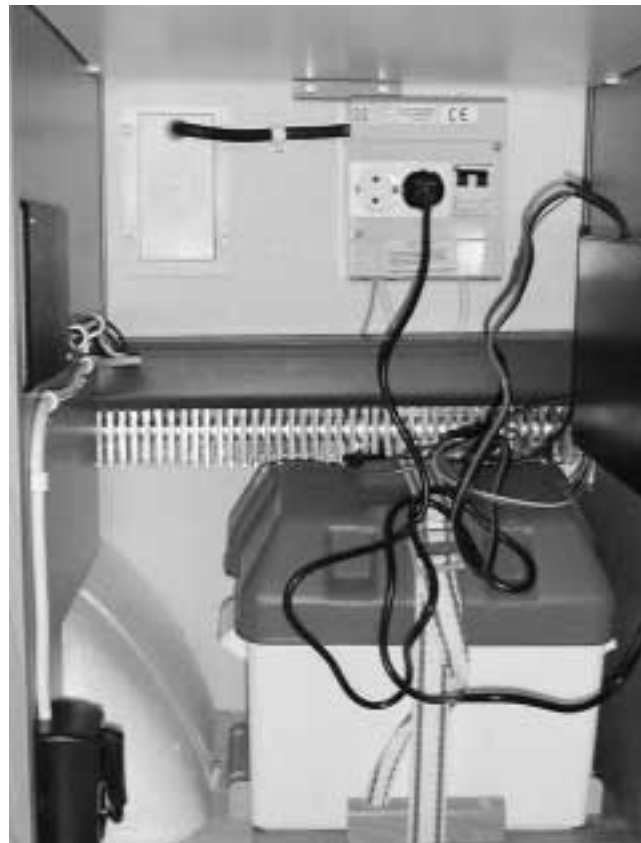
Invändig elcentral med batteribox.
